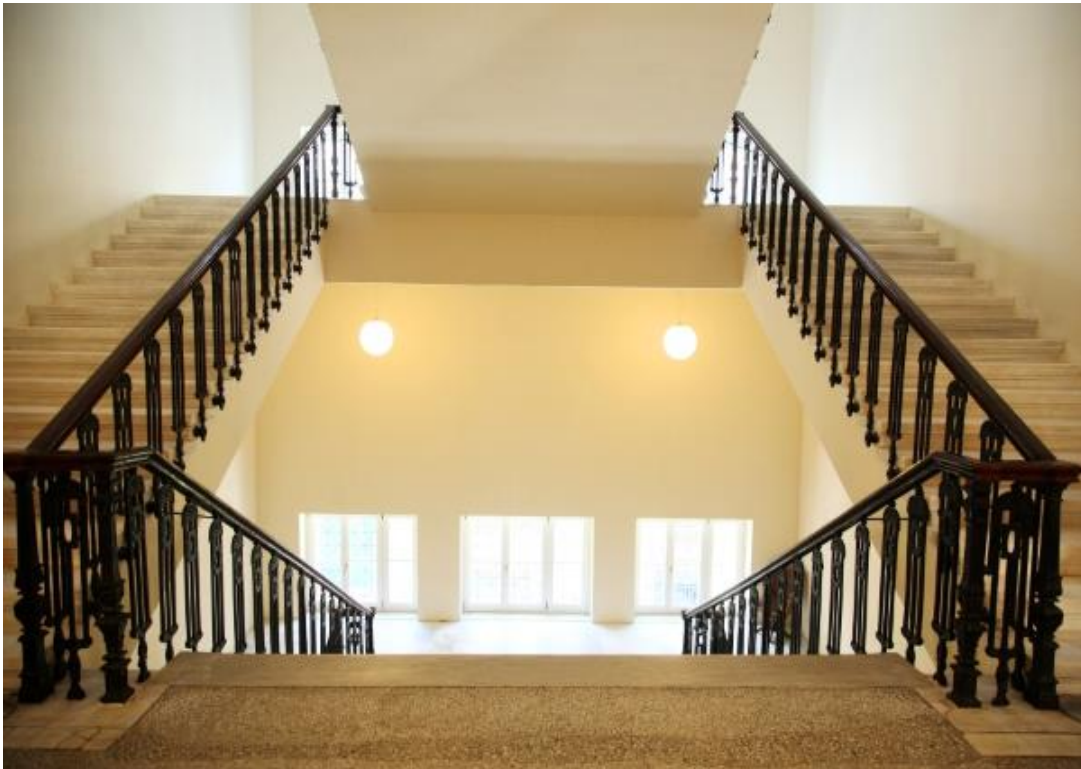
Φωτογραφία της εσωτερικής σκάλας του Κτηρίου όπως είναι σήμερα, μετά την ανακαίνισή του.
